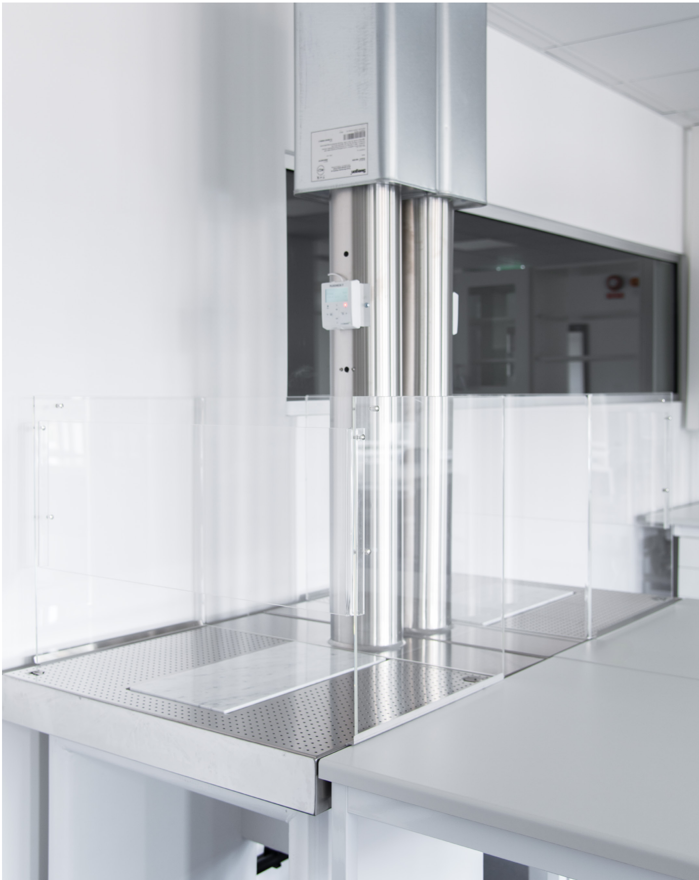
Skyddshuv placerad på ventilerad vågplats.
